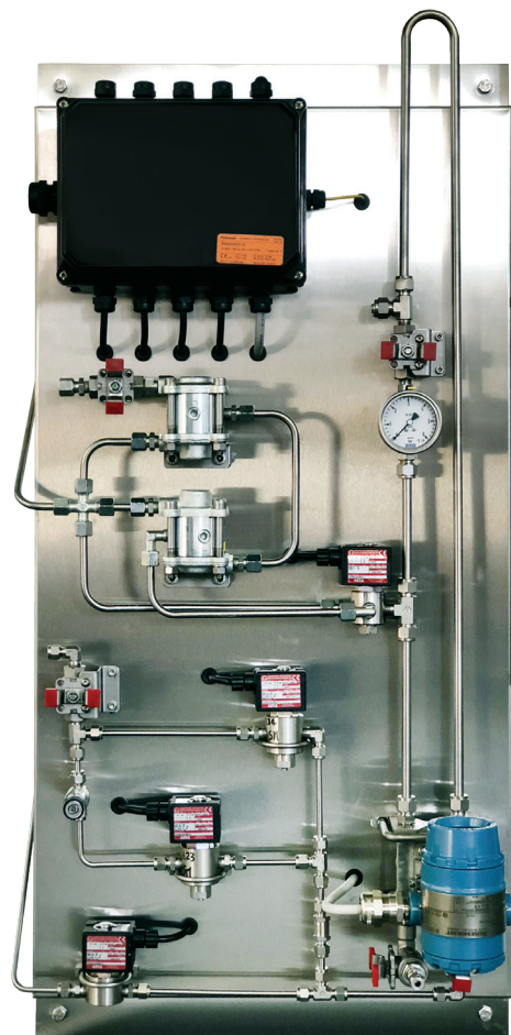
Pannello di Iniezione
